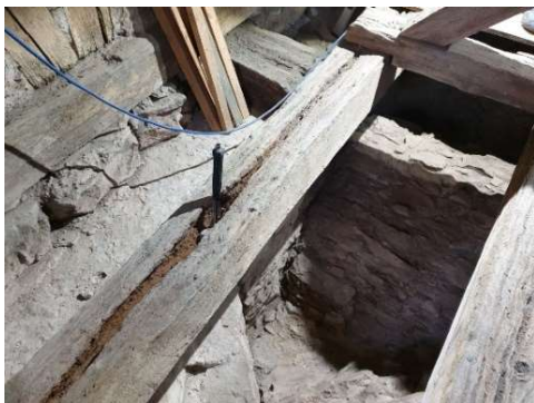
Endergebnis der Arbeiten mit den zutage getretenen Schäden am Gebälk
